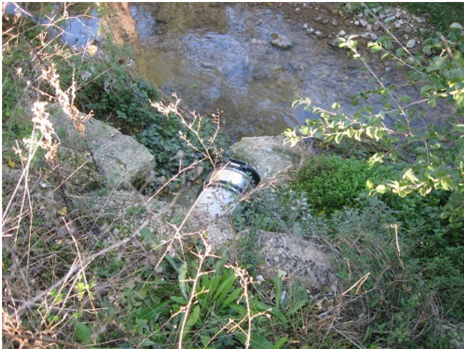
Le déversoir du by-pass
